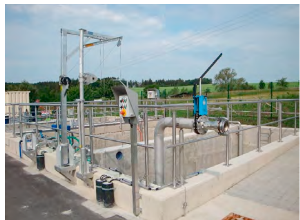
Abbildung 48: Kläranlage Tegau (Quelle: TLUBN)
