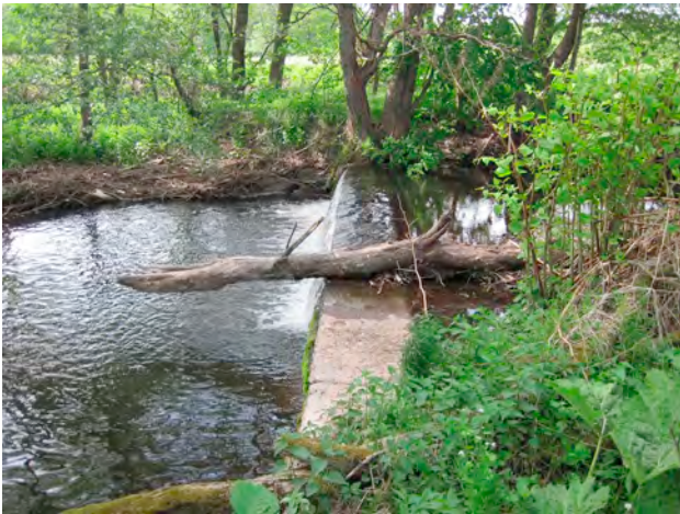
Abbildung 26: Sohlschwelle (Quelle: TLUBN)
