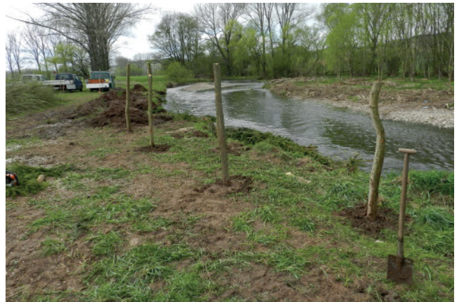
Foto 12: Alternativ zum nachträglichen Zuschlämmen der Bohrlöcher können diese auch vor dem Einbau der Setzstangen mit einem Brei aus Oberboden, Feinmaterial und Wasser verfüllt werden, in den dann die Setzstangen eingedrückt werden. (Foto: A. Stowasser)
