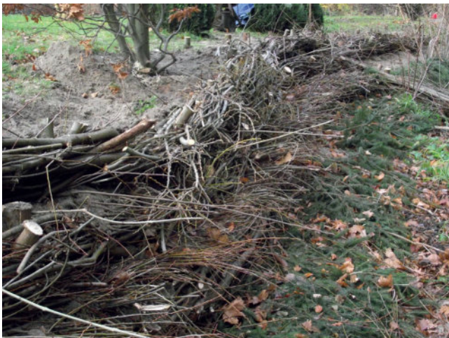
Foto 5: Weidenwippen bieten einen intensiven Schutz für Böschungsfuß und Böschung. (Foto: A. Stowasser)
