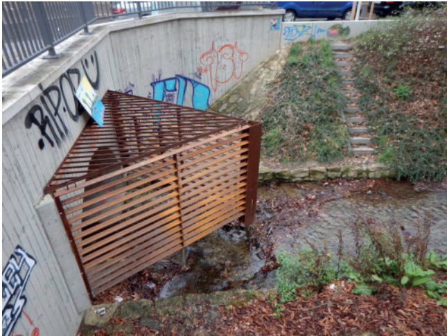
Foto 109: Die Art der Bauausführung orientiert sich an der Art des zu erwartenden Materials und den örtlichen Gegebenheiten. (Foto: M. Dittrich)
