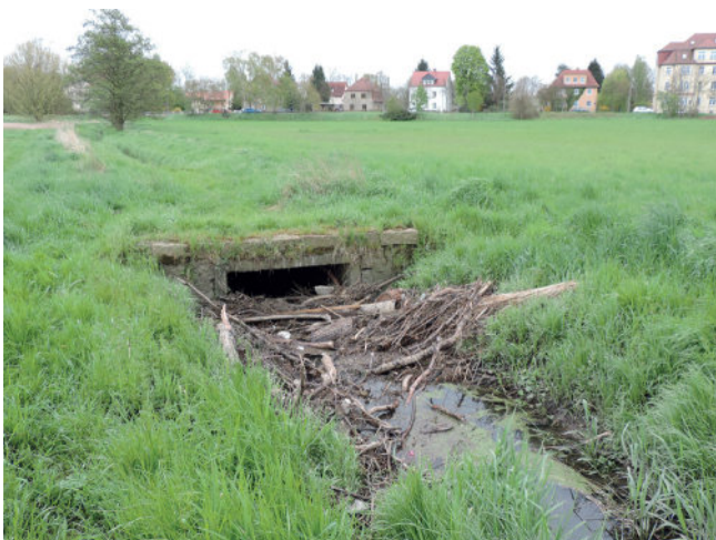
Foto 95: Treibgutansammlung aus Totholz. An Brücken und Durchlässen sowie im Bereich von Gebäuden, Verkehrswegen und Infrastruktureinrichtungen ist eine Beräumung erforderlich. (Foto: A. Stowasser)
