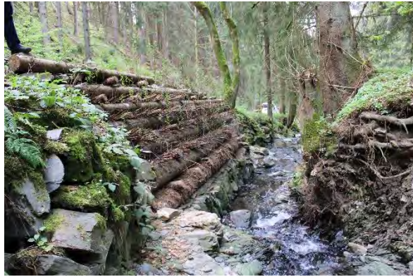
Abbildung 45: Krienerwand zur Böschungssicherung (Quelle: TMUEN)
