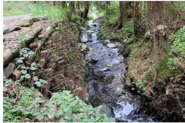
Abbildung 46: Krienerwand zur Böschungssicherung (Quelle: TMUEN)
