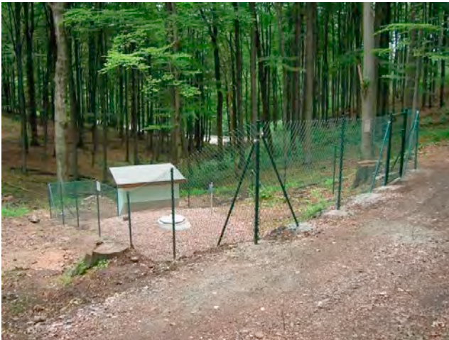
Abbildung 54: Trinkwasserfassung in einem Waldgebiet (Quelle: WAZV Gotha)
