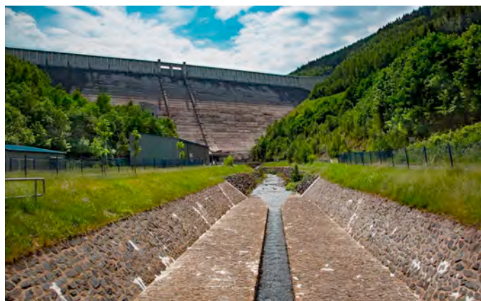
Abbildung 60: Unterwasserabgabe der Trinkwasserstalsperre Leibis/Lichte (Quelle: TFW)
