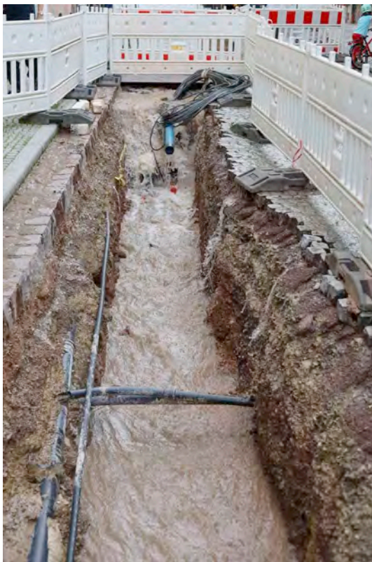
Abbildung 80: Rohrbruch in Ilmenau (Quelle: TMUEN P/Ö)
